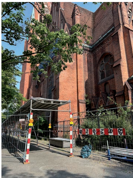
Der Fußgängertunnel rund um die Stephanuskirche soll Passant*innen vor herabfallenden Dachziegeln schützen. Foto: J. Hestermann
